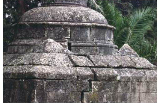
Ilustración 17. Base de la Cruz de la Defensa. Grietas.
